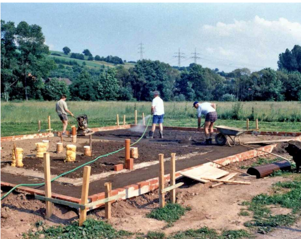
Die Abflüsse sind gesetzt und die Bodenplatte wird von Willi, Helmut und Jakob zum Betonieren vorbereitet
