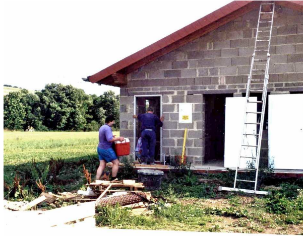
Der Rohbau des Clubhauses ist bald fertig und Walter Krippes sorgt mit Speis und Trank für die gute Motivation der Helfer
