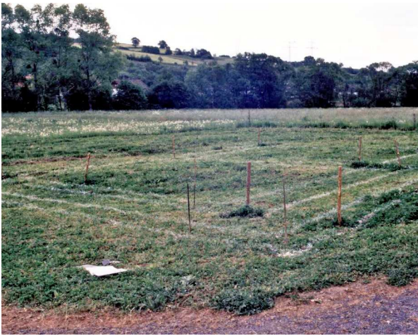
Das Clubhausgebäude wird abgesteckt und die Fundamente werden mit dem Bagger von Walter Frisch und seinen Mithelfern Alwin Lenz, Fred Spath u. Helmut Willems ausgehoben
