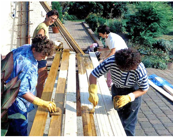
Das Streichquintett Gerlinde, Werner, Agnes, Marlene und Marianne bearbeiten die Profilbretter, die später die Decken im Clubhaus verkleiden
