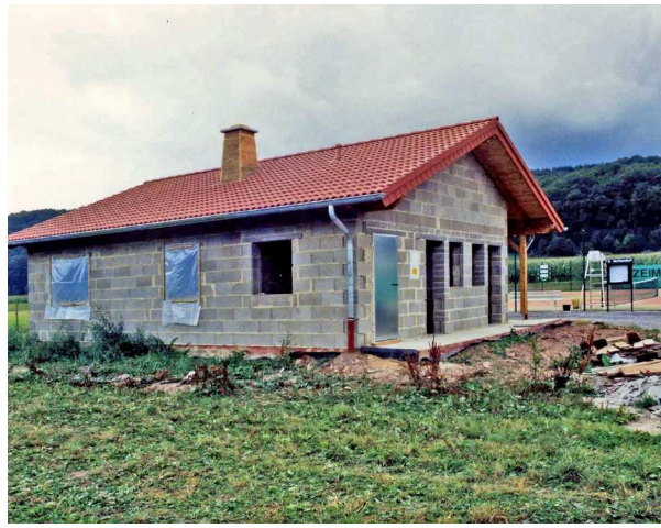
Jakob und Alois verhämmern die letzten Nägeln in der Dachkonstruktion und kurz danach ist auch das Dach schon eingedeckt
